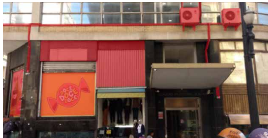
FIGURA 23: Imagem da situação atual da fachada de um edifício em área envoltória (Fonte: SP Urbanismo, 2020)
