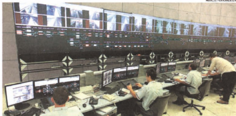
Centro de controle. CPTM concluiu que problemas foram causados só por falha humana
