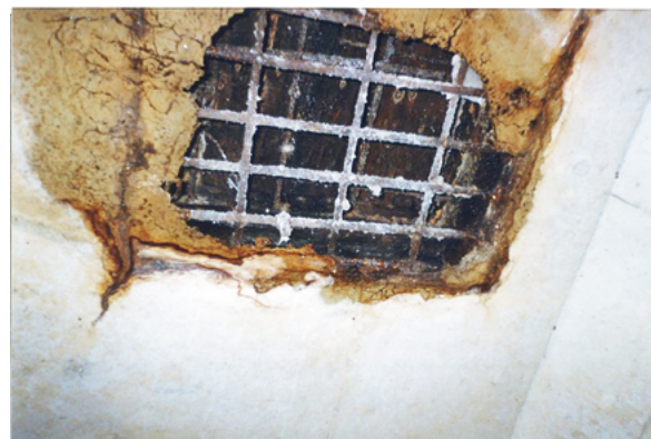
FIGURA 6.38 Danos estruturais dentro de galeria (foto: Enger Engenharia)
