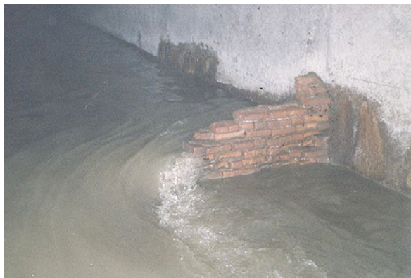
FIGURA 6.37 Interferência dentro de galeria (foto: Enger Engenharia)
