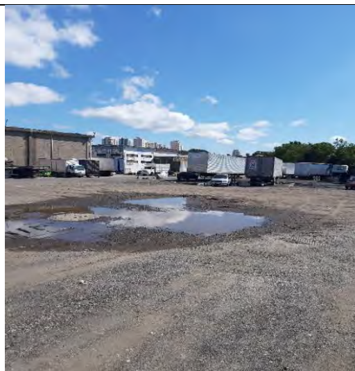
Foto 3.3-53: Acumulo de água de chuvas em depressões no solo.
