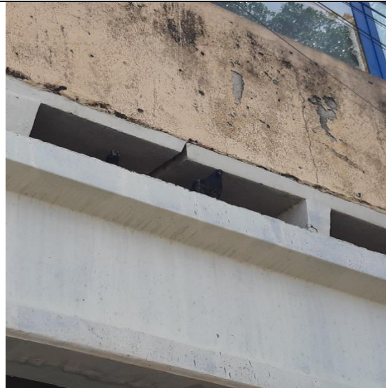
Foto 3.4.2-26: Abrigo de pombos em estrutura das edificações.
