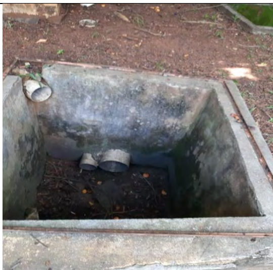
Foto 3.3-65: Caixa de inspeção sem tampa em más condições de conservação e manutenção.
