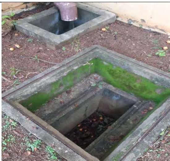
Foto 3.3-66: Caixa de inspeção sem tampa em más condições de conservação e manutenção.
