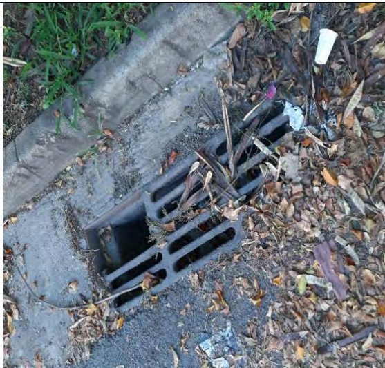
Foto 3.3-46: Bueiros em más condições de conservação.
