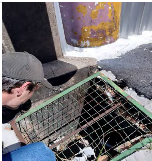
Foto 3.3-49: Pesquisa de sinantropicos e grelhas de escoamento de águas de calhas dos galpões.
