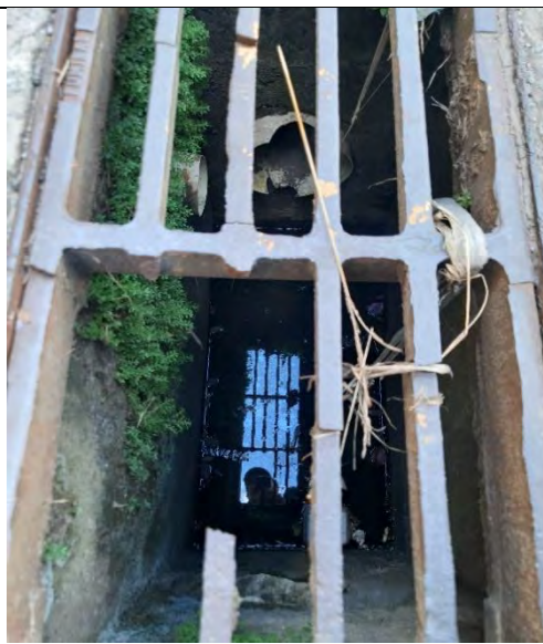
Foto 3.3-45: Água parada em bueiros. Criadouro para culicídeos.
