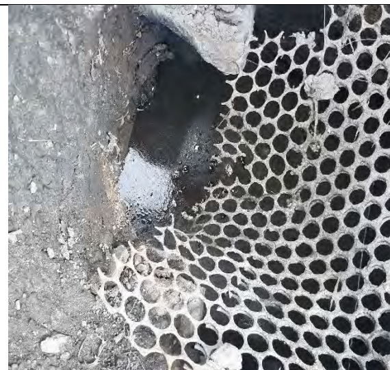
Foto 3.3-48: Água parada em canaleta de escoamento de águas de chuvas das calhas dos galpões.
