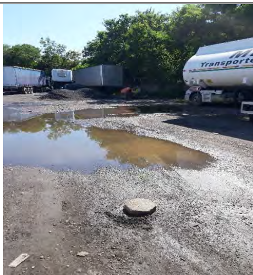
Foto 3.3-51: Acumulo de água de chuvas em depressões no solo.
