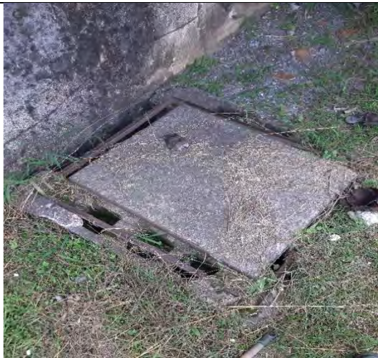
Foto 3.3-62: Falhas de acesso à sinantrópicos em caixas de inspeção em más condições de conservação e manutenção.
