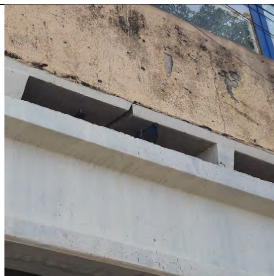
Foto 3.3-26: Abrigo de pombos em estrutura das edificações.
